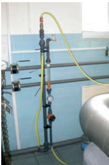
Monitor tvorby biofilmu instalovaný na čerpací stanici
