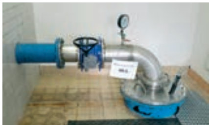
Obr. 1: Původní regulace čerpadla byla řešena uzavírací armaturou
