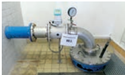
Obr. 3: Na výtlačné potrubí je osazen průtokoměr, nahrazující původní armaturu
