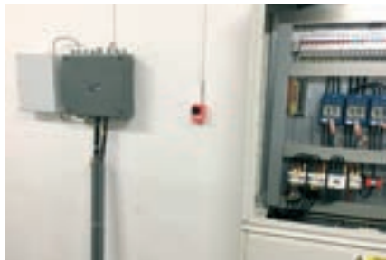
Obr. 2: Rozvaděč před instalací frekvenčního měniče
