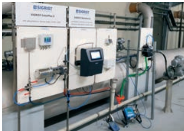
Ověřovací instalace – Vodárna Plzeň, GAU filtrace (analyzátoři SIGRIST ColorPlus , SIGRIST BactoSense , SIGRIST AquaScat )
