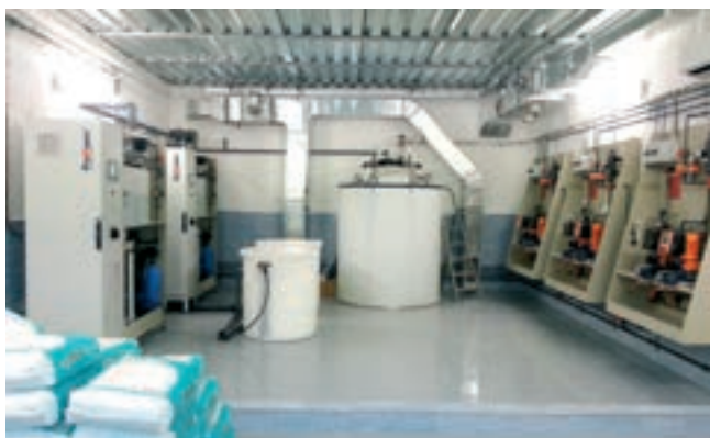
Realizovaný vzduchotechnický systém pro regulaci teploty a odvětrání v prostoru výroby chlornanu sodného ČS Flora – Praha
