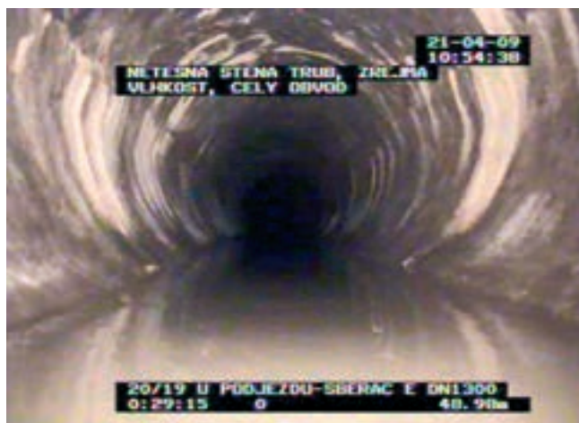
Obr. 3: Stav hlavního sběrače E před opravou
