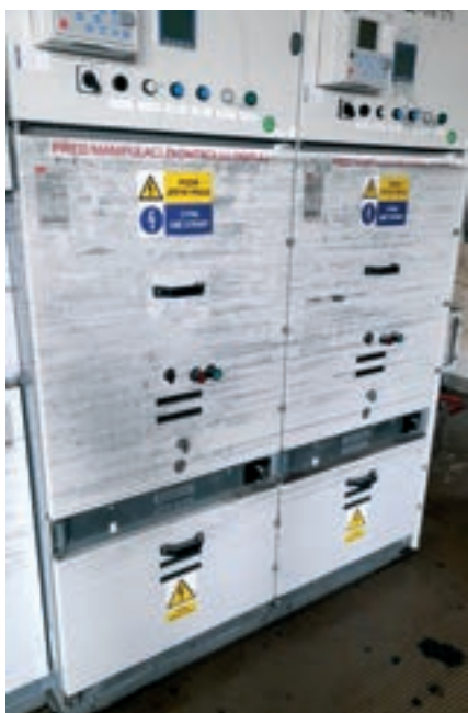
Elektrorozvaděče VN po povodni
