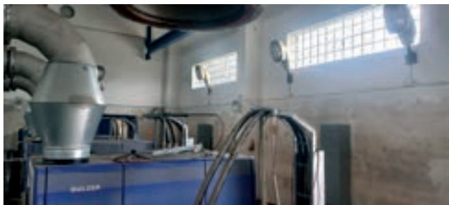
Dmýchadla po opadnutí vody
