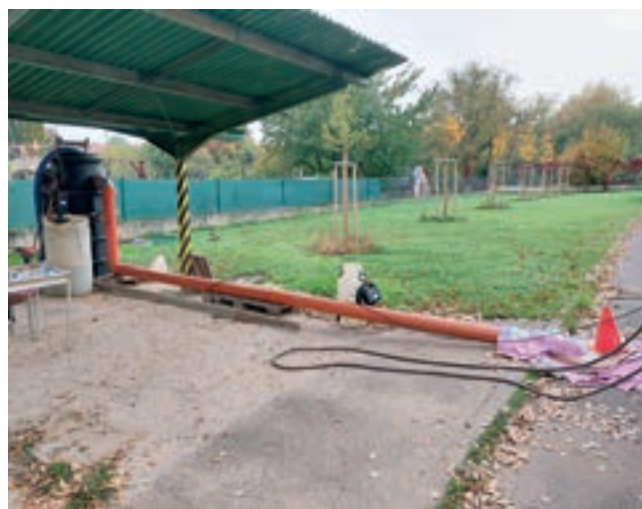
Obr. 2: Testovací místo 2 – výtlač z obce Dyje do ČOV Znojmo (výtlač, šachta, sonda \text{H}_2\text{S} a dávkovací čerpadlo s nádrží pro síran železitý)
