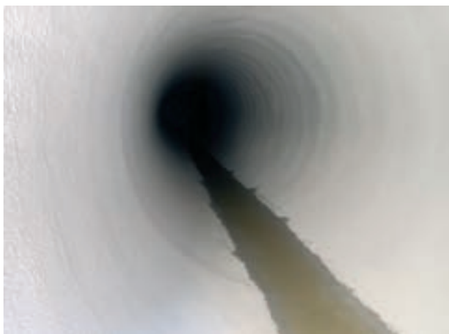
Obr. 3: Sanovaná kmenová stoka E DN 2 200, sanace maltou Ergelit
