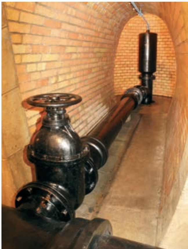
I. březovský vodovod – štolá jímacího zařízení
