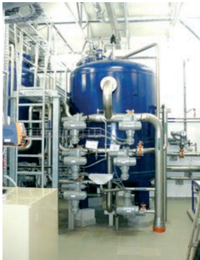
Obr. 2: Filtrace přes dva tlakové filtry
