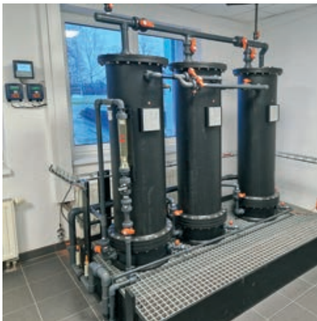
Obr. 4: Neutralizační stanice anolytu na ÚV Nebanice
