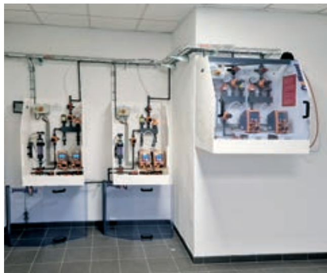
Obr. 3: Dávkovací čerpadla chlornanu sodného v ÚV Nebanice
