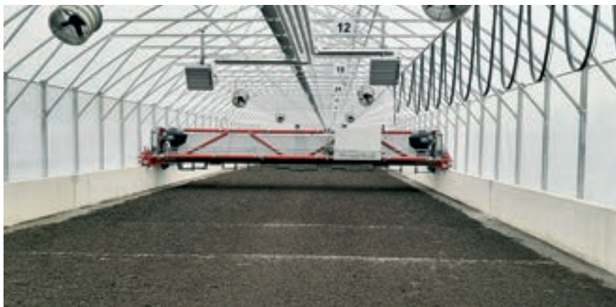
Interiér sušárny ČOV Mariánské Lázně
