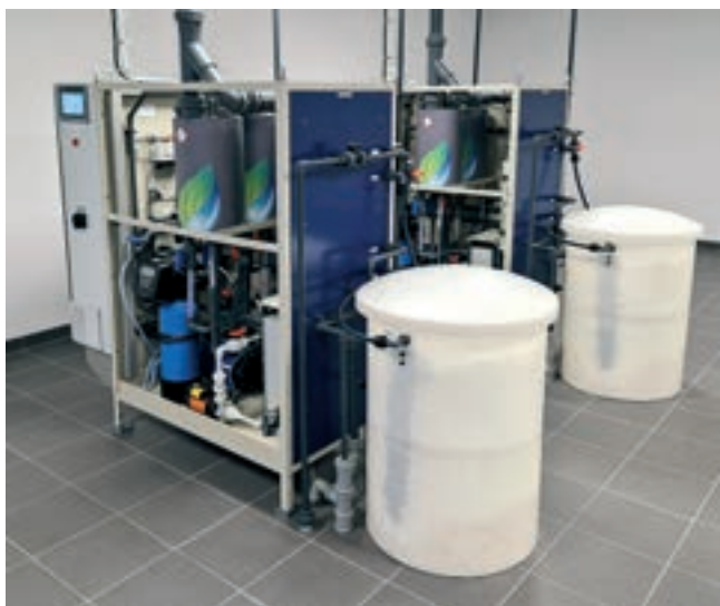
Obr. 1: Jednotky elektrochlorace na ÚV Nebanice
