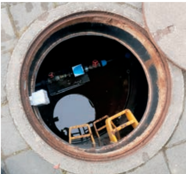
Namontovaný vodoměr iPERL a smart point v šachtě: smart point se nachází těsně pod poklopem z důvodu lepšího signálu
