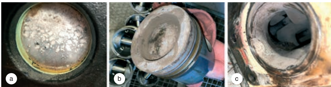
Obr. 2a, b, c: Negativní projevy siloxanů v praxi na ČOV Hradec Králové – zanesené revizní okénko hořáku kotle na bioplyn (vlevo) a zanesené písty a spalinné cesty KGJ (vpravo)
