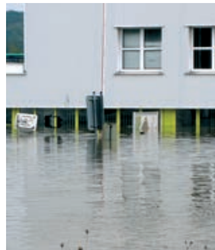
Zaplavený vstup do správní budovy ÚČOV
