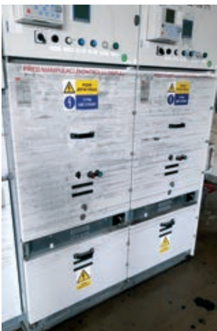
Elektrorozvaděče VN po povodni
