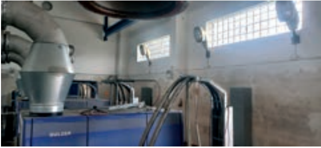
Dmýchadla po opadnutí vody
