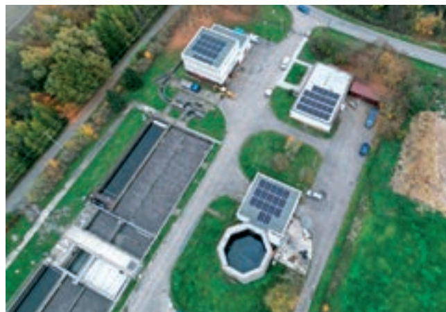
Instalace FVE na ČOV Heřmanův Městec
