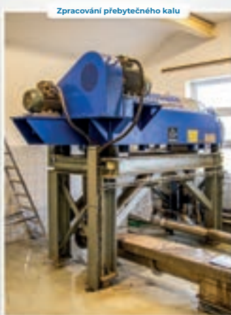
Na odstředivce ČOV Mělník odvodníme veškerý produkovovaný kal.
