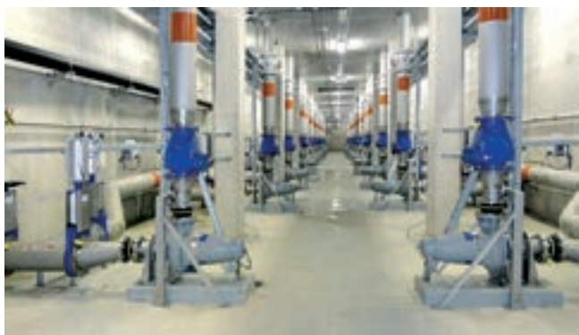
NVL, čerpadla biologického kalu
