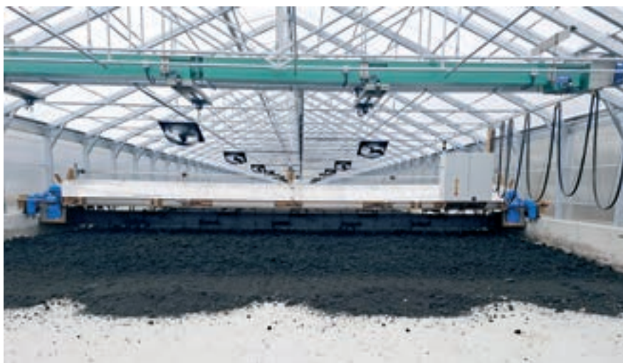
Obr. 6: Vnitřek haly s dopravníky, prohrabávacím zařízením a ventilátory
