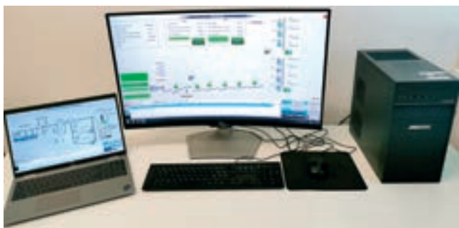
Dispečerské pracoviště ČOV
