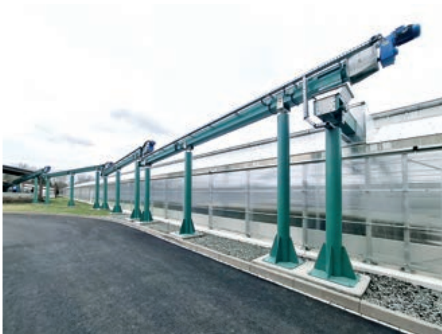
Obr. 4: Dopravníky kalu vně haly
