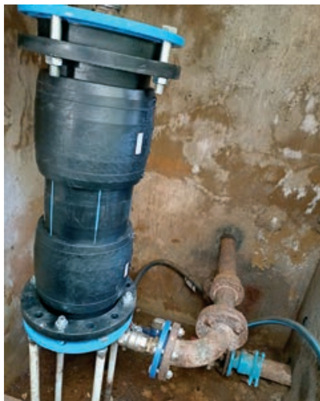
Obr. 8: GAU filtr instalovaný na přítoku do vodojemu Světec
