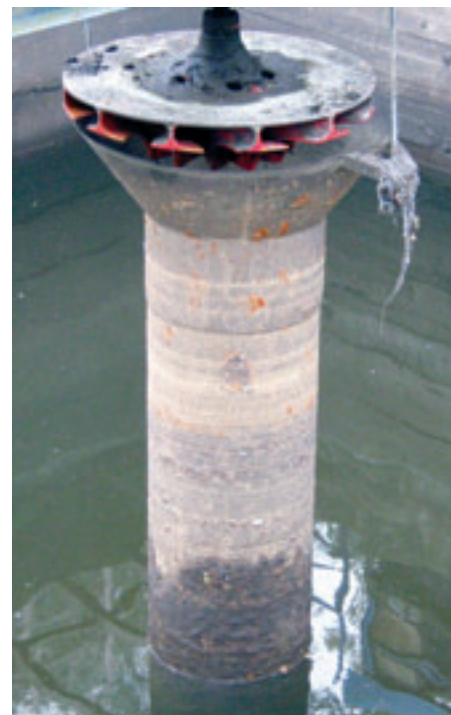
Obr. 6: Kompletní pohled na aerační turbínu
