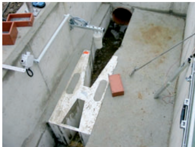
Obr. 7: Protiproudí pohled na plastové provedení Parshallova žlabu včetně ultrazvukového hladinoměrného snímače
