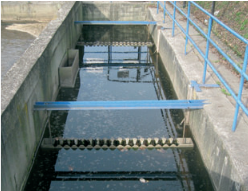
Obr. 3: Podélná dosazovací nádrž
