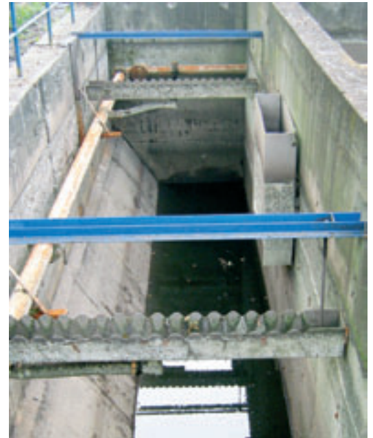
Obr. 4: Vystrojení dosazovací nádrže
