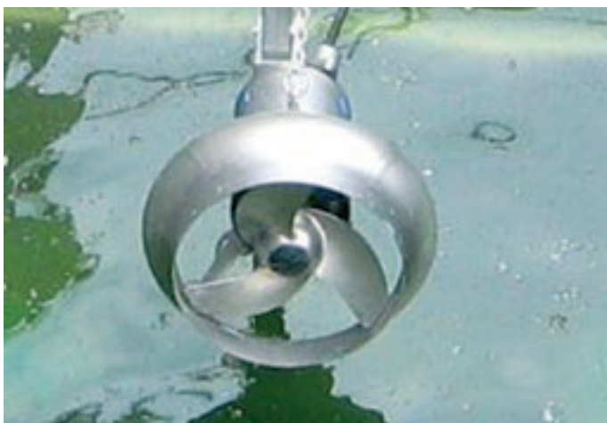
Obr. 8: Míchání aktivčních nádrží zajišťují dvě ponorná míchadla
