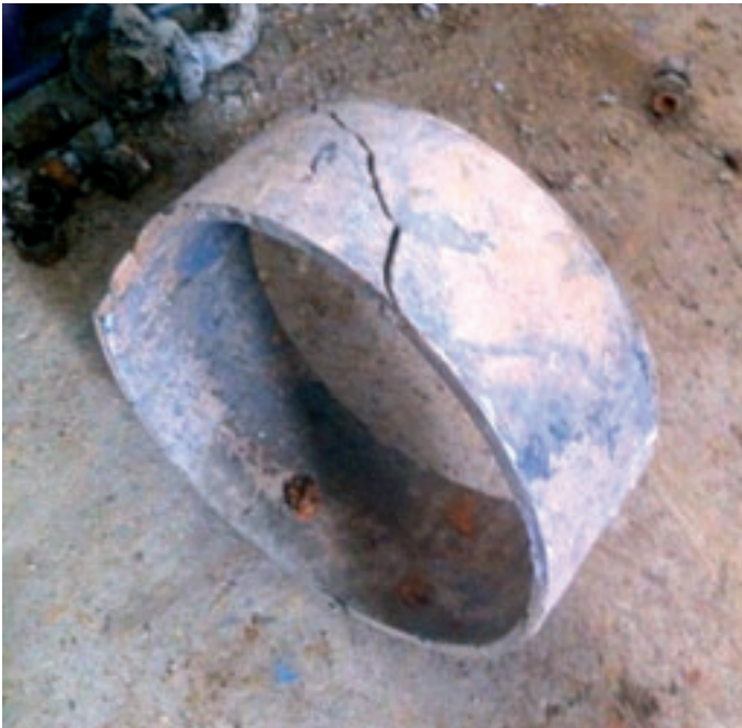
Obr. 5: Příklad poškozeného potrubí pohybem zeminy (lom potrubí litina DN 300)
