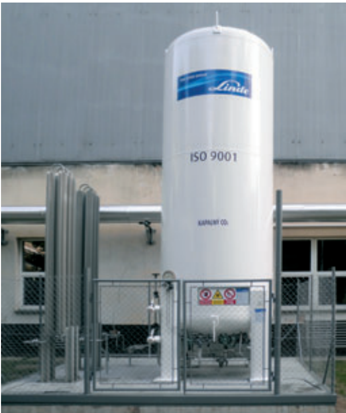
Obr. 2: Zásobník kapalného CO 2 – odpařovací stanice pro technologii neutralizace SOLVOCARB®
