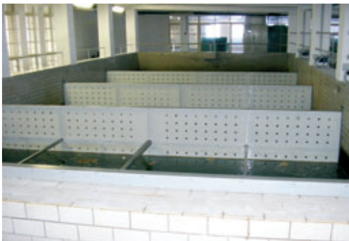
Flokulační nádrže se systémem děrovaných stěn
