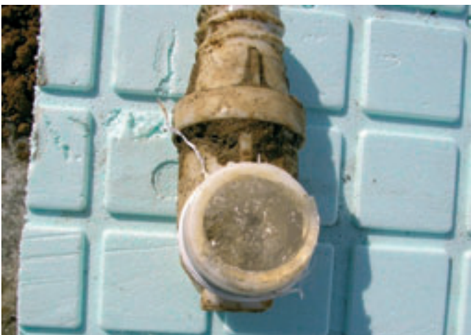
Obr. 7: Detail zamrzlé vody v uzávěru vodovodní přípojky (Štramberk Hornychovice)
