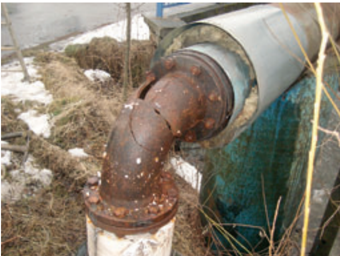
Obr. 6: Příklad poškozené tvarovky mrazem na vodovodním přemostění po odstranění tepelné izolace (Palkovice, litina DN 150)
