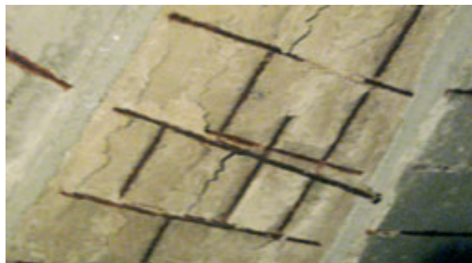
Obr. 2: Degradace ŽB stropu akumulací nádrže před sanací
