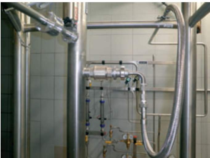
Obr. 1: Speciální tryska technologie SOLVOCARB®-D v provozu neutralizace odpadních vod, v pozadí třicestný regulační panel CO 2
