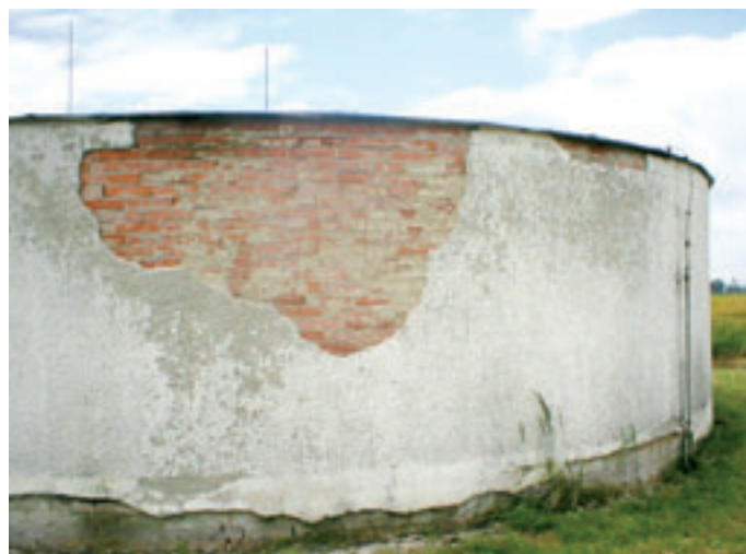
Obr. 1: Narušená fasáda a zdivo akumulací nádrže před sanací
