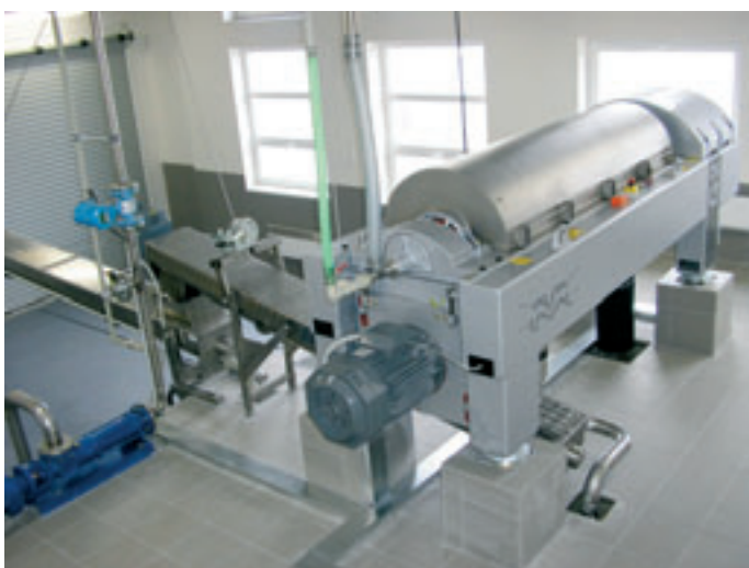
Budova kalového hospodářství – odstředivka pro strojní odvodňování kalů
