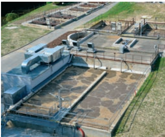
Pohled na nitrifikační nádrže
