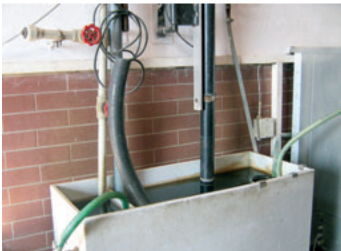
Obr. 2: Umístění sond v průtočné vaně na odtoku z ÚČOV
