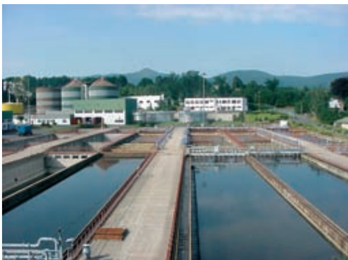
Obr. 1: Pohled na kalové hospodářství
