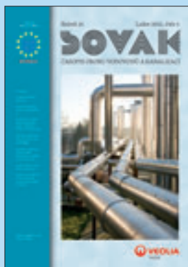
Titulní strana: Čistírna odpadních vod, Pivovar Svijany. Pohled na trubní vedení a v zadní části na anaerobní Biobed® EGSB reaktor na ČOV Svijany, rekonstruované společností VWS Memsep ve spolupráci se společností Česká voda – Czech Water
