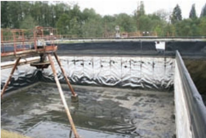
Čistá Ploučnice: ČOV Jablonné v Podještědí
