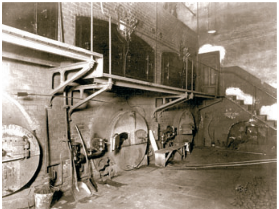
Úprava vody Pisárky – kotelna
