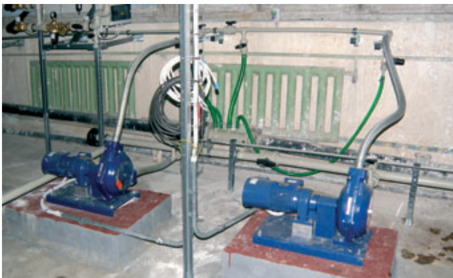
Dávkovací peristaltická čerpadla vápenného mléka na ÚV
