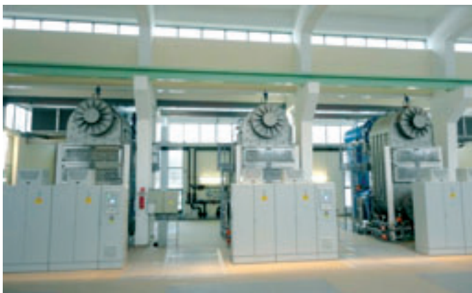
Obr. 3: UV dezinfekce na výtlaku čerpadel 2. stupně čerpání
