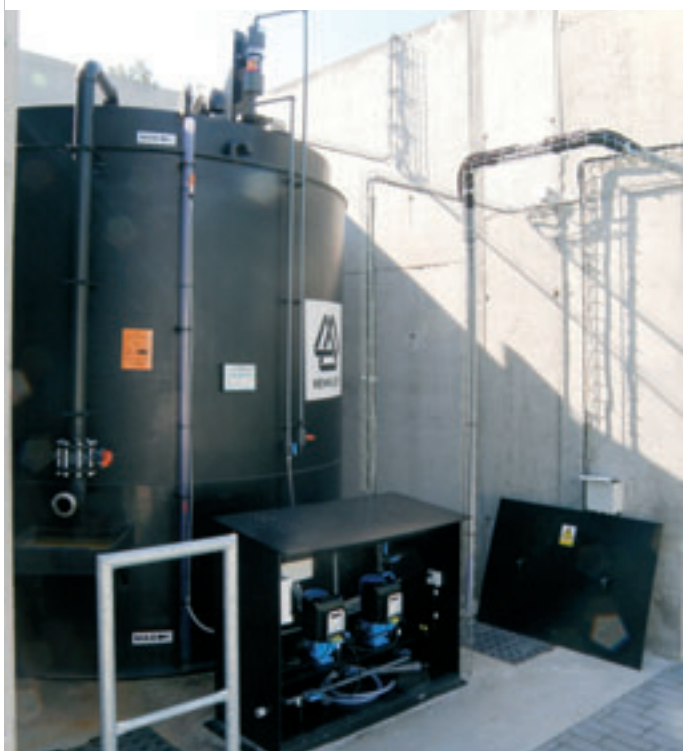
Kompletní jednotka pro skladování a dávkování síranu železitého
