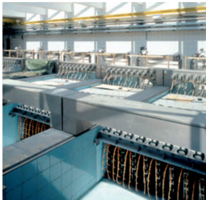
Obr. 2: UV dezinfekce odpadních vod na ČOV Mnichov – Gut Marienhof
