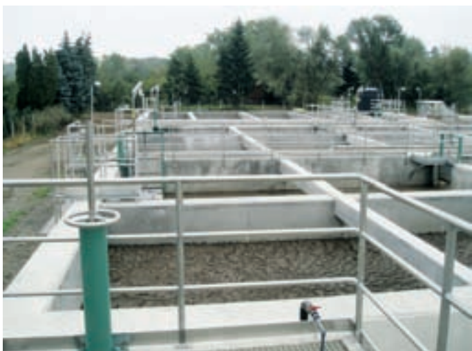
Rekonstruované aktivační nádrže ČOV Lipník nad Bečvou
