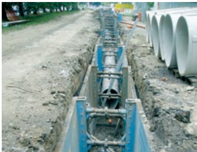
Přerov – vejčitá stoka AD s profilem z Polymerbetonu
