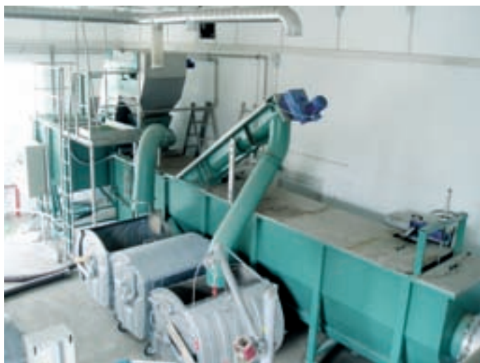
Jednotka mechanického předčištění ČOV Lipník nad Bečvou
