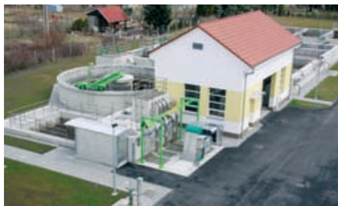
Mechanické předčištění, čerpací stanice a usazovací nádrž
