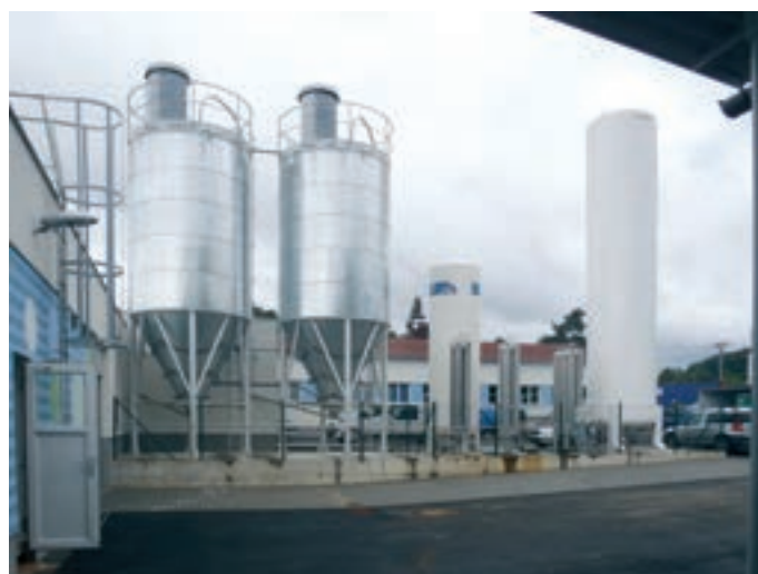
Zásobníky s vápenným hydrátem a technickými plyny
