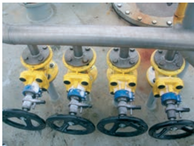
Víková šoupátka s ukazatelem, instalovaná na biotechnologii ČOV. Jedno z vhodných míst pro aplikaci třmenového šoupátka
