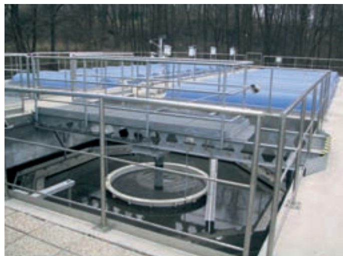
Obr. 1: ČOV Ostrava-Michálkovice, nitrifikační a denitrifikační nádrže jsou zastřešeny z důvodu zamezení zápachu
