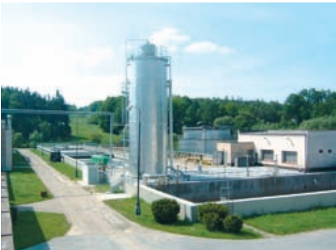
Celkový pohled: v popředí je havarijná a vyrovnávací nádrž, dále IC reaktor a následuje aerobní dočištění
