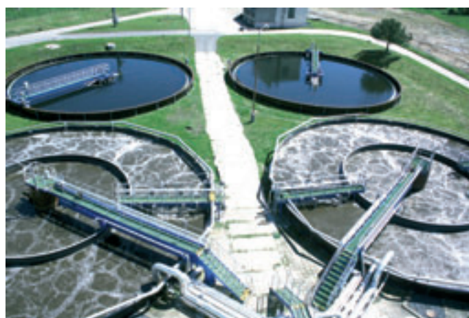
ČOV Mariánské Lázně – aktivační a dosazovací nádrže
