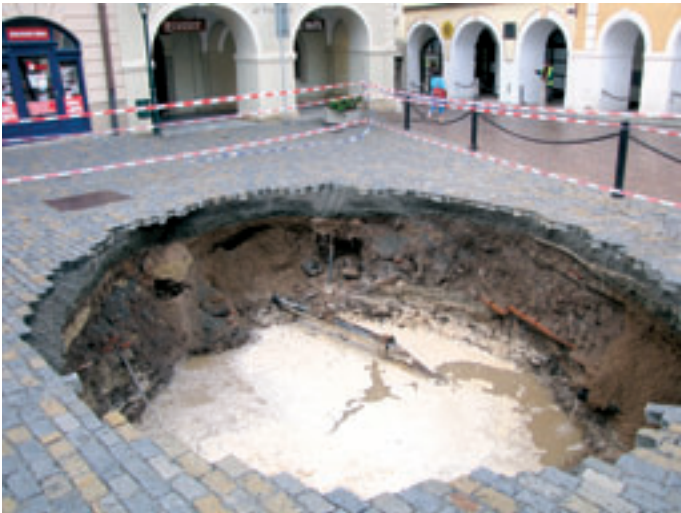
Obr. 8: Propad šachty na rohu Šultysovy a Husovy ulice (foto archiv VHS)
