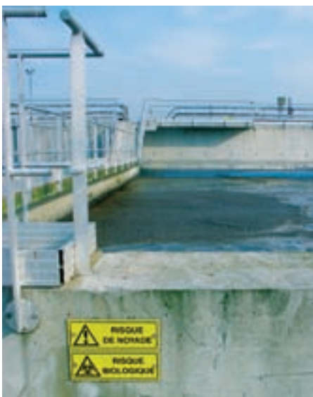
Jednotlivé úseky a pracoviště ČOV jsou označeny tabulkami s upozorněním na konkrétní rizika
