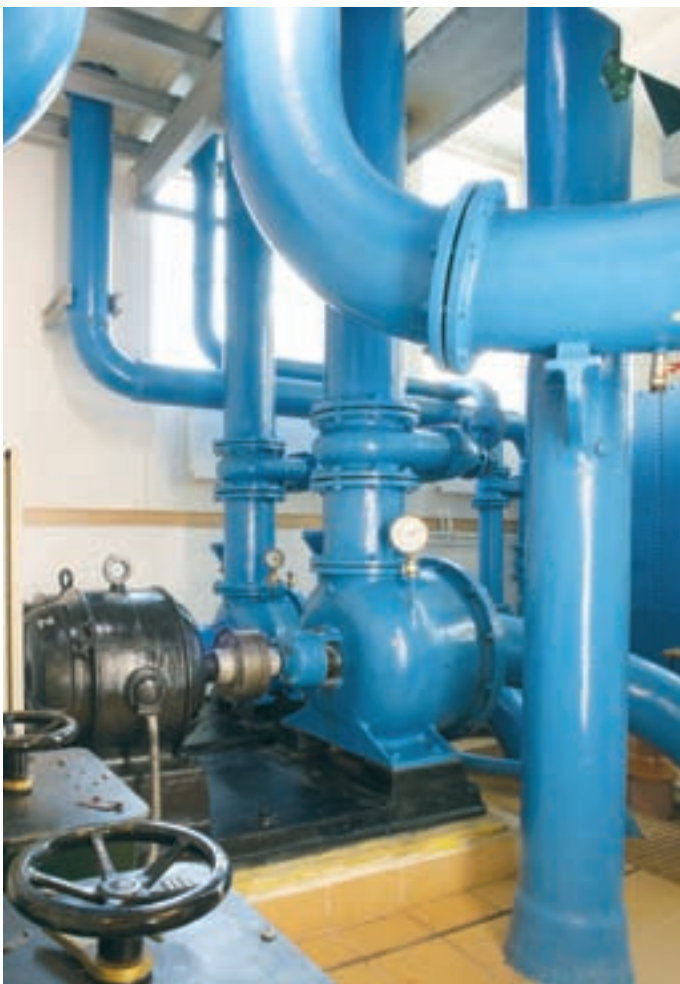
Obr. 1: Pohled na čerpací agregáty a rozvodná potrubí před rekonstrukcí ČS
