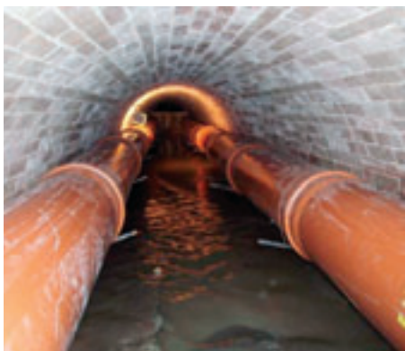
Obtokové potrubí ve stoce B
