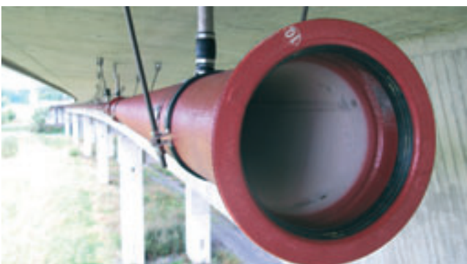
Obr. 12: Odvodňovač mostní konstrukce
