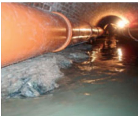
Obtokové potrubí ve stoce B
