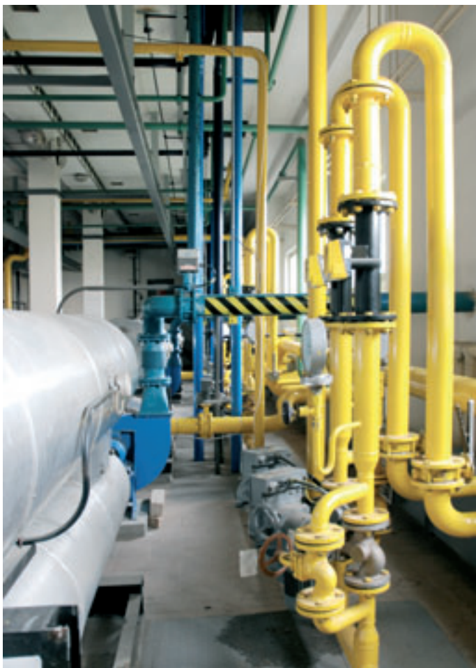
Interiér úpravny vody
