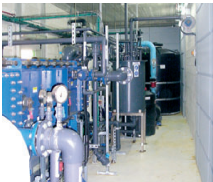
Obr. 7: Pohled do denitrifikační stanice (selektivní elektrodialýza) v Nescioně u Tel Avivu
