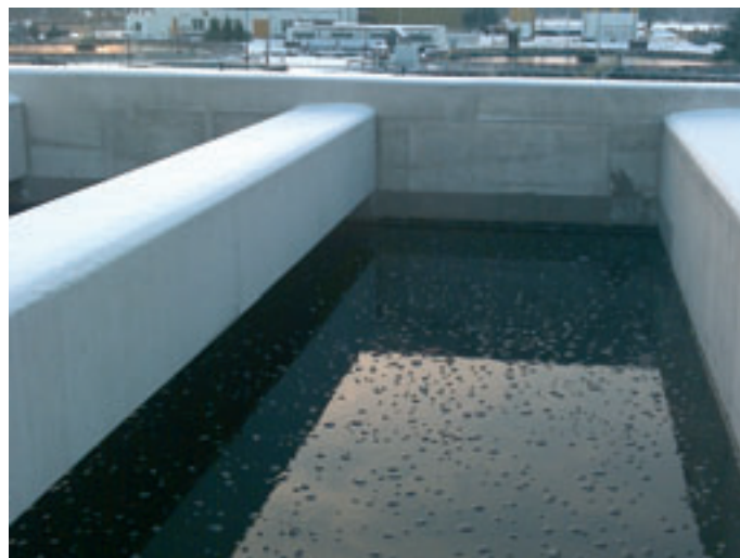
Obr. 5: Pohled do komory PDN filtru při vyšším zatížení – dobře patrné bublinky vznikajícího plynného dusíku
