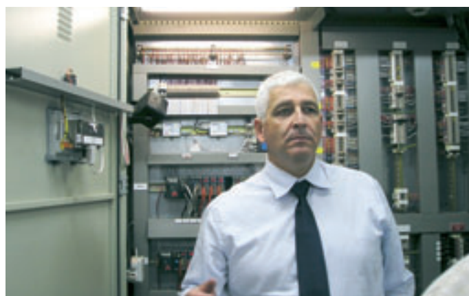
Obr. 6: Řídicí systém stokovací sítě splaškových vod z rozptýlených aglomerací s čištěním a s následnou distribucí na závlahy ve firmě Realite Q (rozhodující procesory jsou 2 malé „krabičky“ vlevo od hlavy ředitele firmy)
