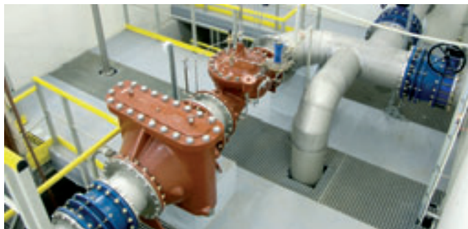
Obr. 7: Vodojem Nebovidy – armaturní komora
