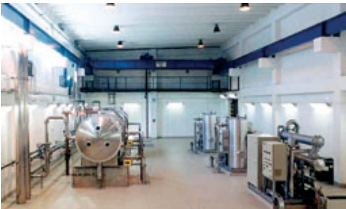
Obr. 5: Úpravna vody Švařec – ozonizace
