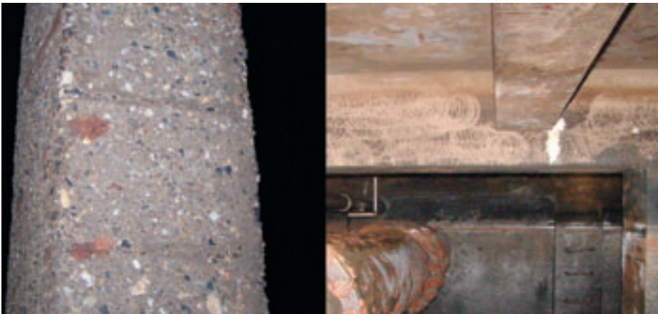
Obr. 5: Charakteristické jevy na povrchu v nádržích: a) vliv vyluhování povrchových vrstev cementového tmelu – sloup ve vodojemu po 25 letech; b) stopy čištění tryskáním při vysokém tlaku – abrase na cementové omítce
