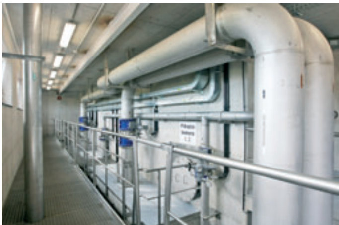
Armaturní prostor PDN filtru
