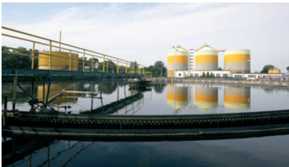
Dosazovací nádrž, v pozadí vyhnívací a uskladňovací nádrž kalu
