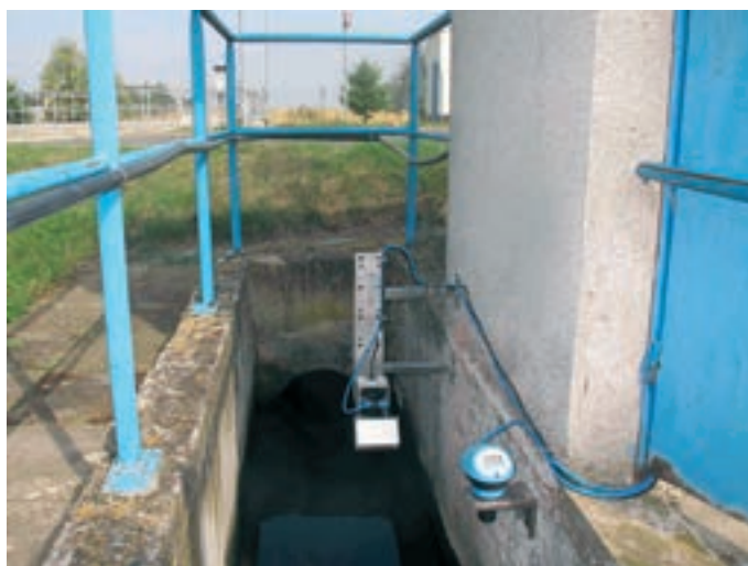
Obr. 3: Instalace na odtoku ČOV Čertousy
