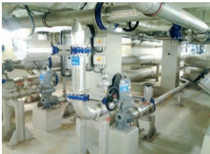
Čerpací stanice kalového hospodářství
