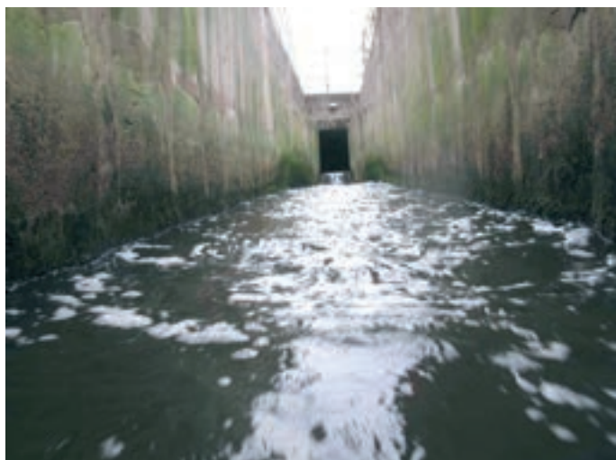
Obr. 8: Detail vlnění pod Venturiho žlabem na odtoku z DN 6, 8 na ÚČOV Praha
