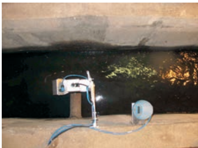
Obr. 6: Pohled shora na instalaci ve žlabu mezi česlemi a lapáky písku na ČOV Kbely
