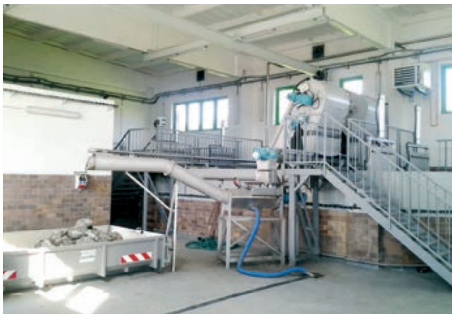
Hala hrubého předčištění
