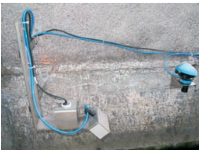
Obr. 4: Detail instalace radarového OFR senzoru a hladinového senzoru NivuCompact
