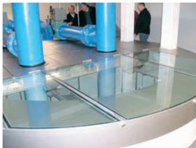
Obr. 4: Moderní úprava zhlaví vrtu u jednoho zdroje vodovodu ve Winterthuru
