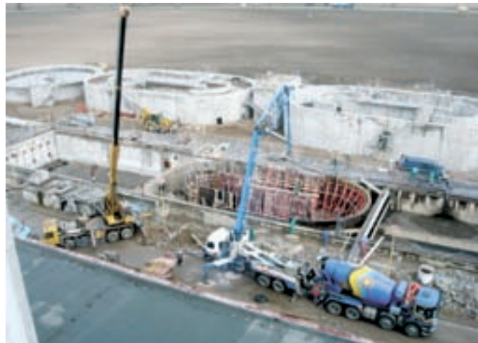
Střední Pomoraví/Hodonínsko, projekt č. 1 Bzenec – rekonstrukce ČOV. Aktivační a dosazovací nádrže, selektor
