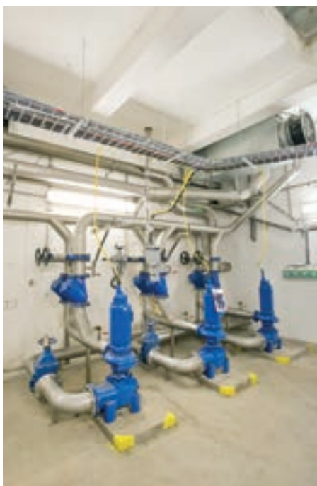
Obr. 3: Vstupní čerpací stanice
